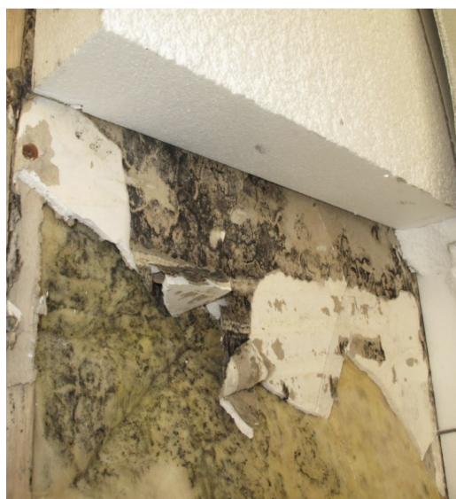
Pleśń powstała w wyniku źle wykonanej przegrody ściany zewnętrznej.
